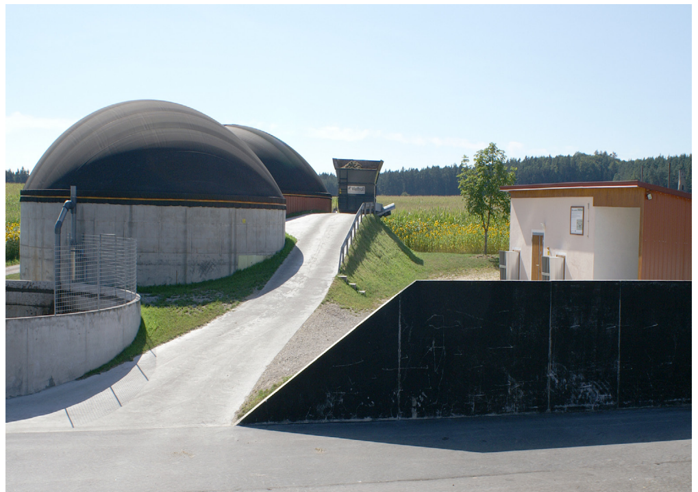
Installation de méthanisation agricole. Source agriKomp.
