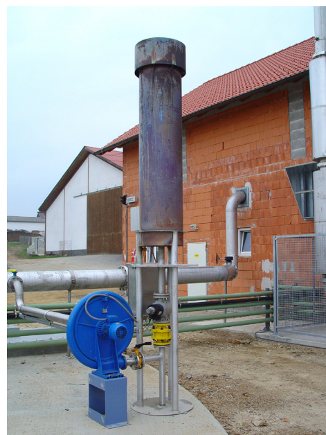
Torchère et son dispositif de ventilation. Source : Biogas Hochreiter GmbH - A.E.B. - Méthafrance.
